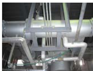
株式会社深川硝子工芸様 廃熱利用熱交換器
