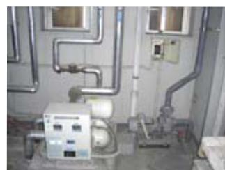
株式会社深川硝子工芸様 雨水再利用設備
